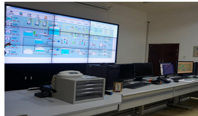
废液处理总控室
