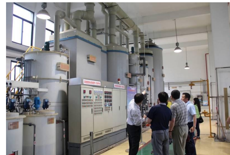
废液处理装置
