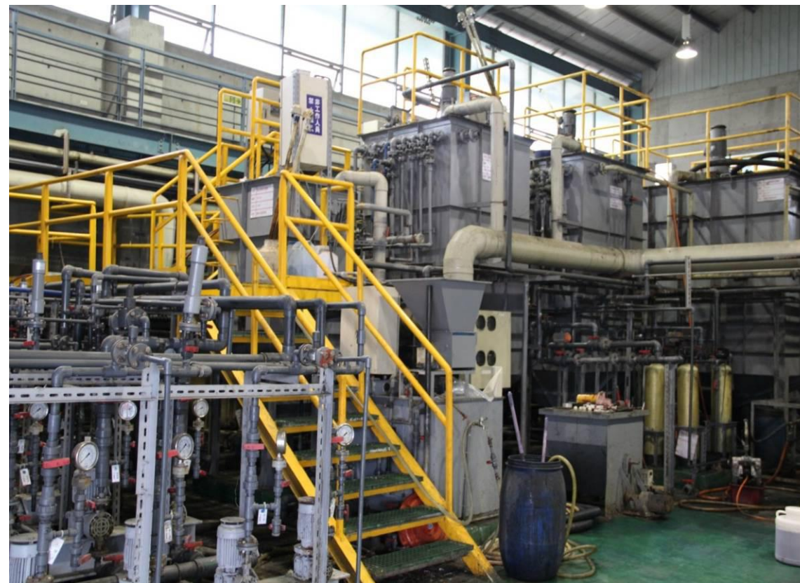
中国台湾云林科技大学实验室废液处理装置
